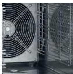
Détails de la ventilation interne
